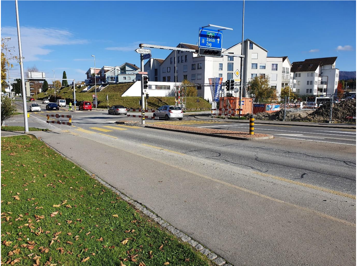
An der Kreuzung Chamer-/Berchtwiler-/Poststrasse in Rotkreuz wird die defekte Lichtsignalanlage zurückgebaut und bis zur Umgestaltung der Strasse ein provisorischer Kreisellösung erstellt.
