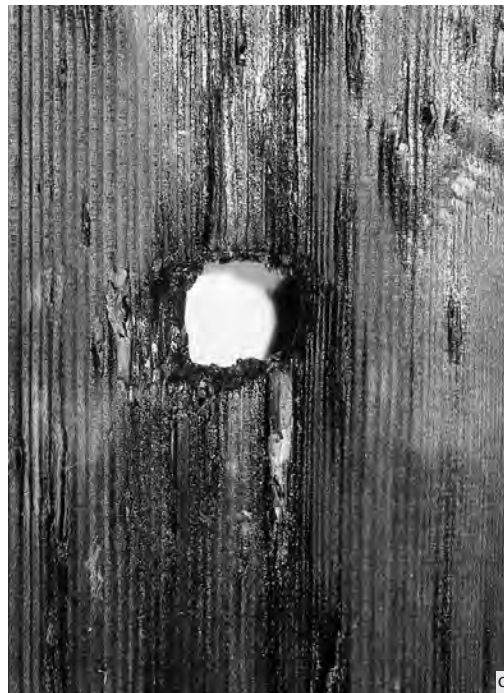
Abb. 161 Steinhausen-Chollerpark, OS. Unterseite einer Schindel mit oberflächlich angebrannter (firstorientierter) und unverbrannter (traufseitiger) Partie, weil dort die nächstfolgende Schindel unterlag. Einzig durch das Loch wurde ein entsprechender viereckiger Fleck angesengt (Pfeil; Taf. 38, 258). M. ca. 1:7.
