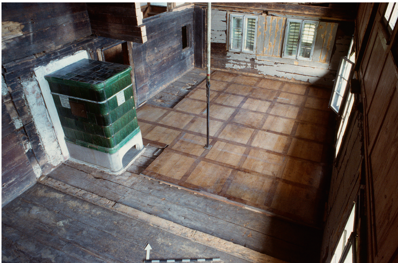
Abb. 100: Ofenstandort in der Stube von Haus Oberzittenbuch in Unterägeri (Kat. 17), 1555d, in der Ecke zwischen Querwand und Trennwand zur Nebenstube; der abgebildete Ofen wurde gemäss Inschrift im Jahr 1820 gesetzt.
