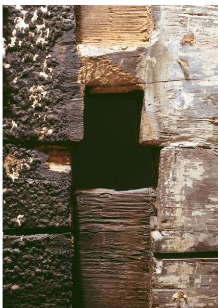
Abb. 25: Fehlstelle bei einer Verkämmung mit Einzelvorstoss beim Haus Artherstrasse 128 in Oberwil bei Zug (Kat. 28), um die Mitte des 15. Jahrhunderts; erkennbar sind die unterschiedlichen Ausschnitte in den beiden angrenzenden Balkenlagen.
