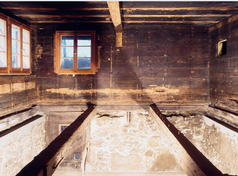
Abb. 55: Nach dem Entfernen der Bodenbohlen in der Stube von Haus Stockeri 9 in Risch (Kat. 21), 1557d, sind die Unterzüge für den Fussboden sichtbar.
