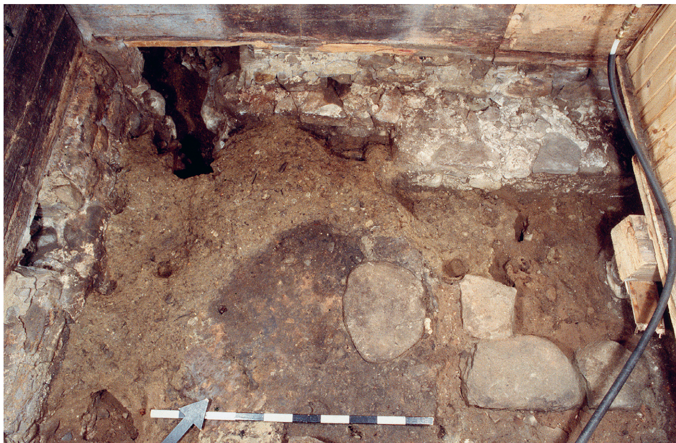
Abb. 275: Der Küchenbereich (1.5) von Haus Unterblacki in Unterägeri während der bauarchäologischen Untersuchung 2007. Zu erkennen ist die partiell erhaltene Vormauerung vor der rückwärtigen Giebelfassade.
