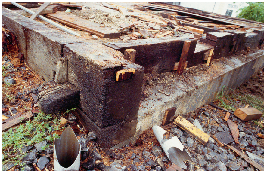
Abb. 287: Die Schwellen aus Eichenholz von Haus Holzhäuserstrasse 2 in Risch sind mit Schlössern verbunden; ihre Oberkanten liegen auf einer Ebene.
