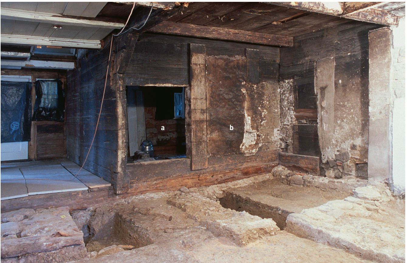
Abb.99: Bauzeitliche Wandaussparung für einen Heizofen in der Stube im Hinterhaus des ersten Vollgeschosses von Haus Dorfstrasse 17/19 in Walchwil (Kat. 23), 1580d: a) Aussparung für den Heizofen; b) zugemauerte, bauzeitliche Türöffnung in die Stube im Hinterhaus.
