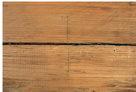
Abb. 28: Bundseitiger Anriss auf zwei angrenzenden Balkenlagen für die Einbringung eines Dübels im Haus Gulmstrasse 32 in Oberägeri, 1789d (Ereignisnr. Archäologie 1968).
