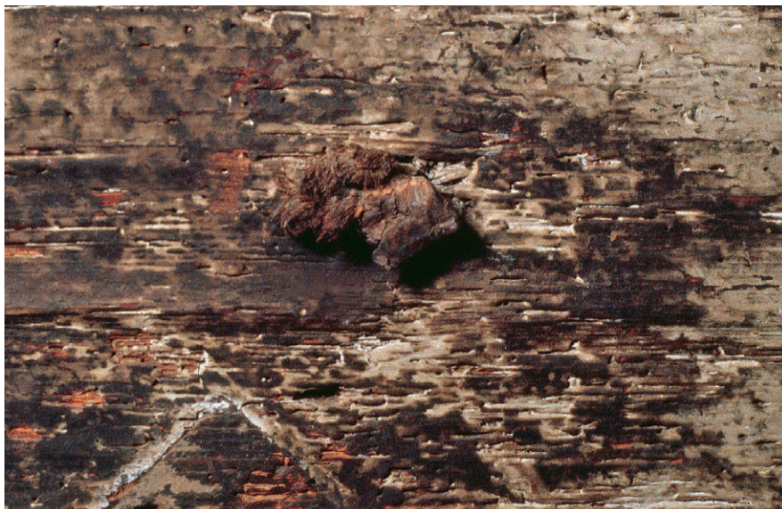
Abb. 149: Eine Verpflöckung mit herausschauendem Werg in Haus Artherstrasse 125/127 in Oberwil bei Zug (Kat. 27), 1577d.
