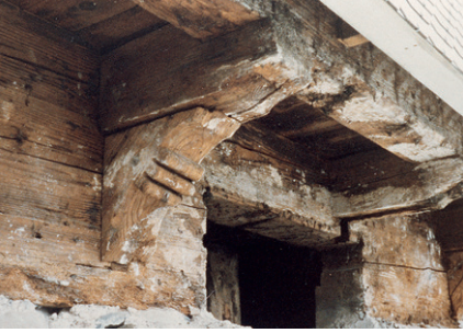
Abb. 70: Die Winkelhölzer beim Haus Hauptstrasse 5 in Oberägeri (Kat. 13), 1547d, waren oben durch Zapfen in die Trägerbalken eingelassen und griffen in der Vertikalen mit einem Kamm in die hölzerne Sockelaufhöhung.
