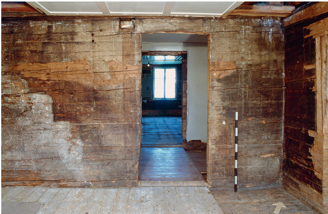
Abb. 194: Sekundäre Türöffnung in der Nordwand der Eckkammer (1.3) von Haus Neudorfstrasse 6 in Menzingen; links von der Türöffnung zeichnet sich das Negativ eines Kachelofens mit Ofentreppe ab.
