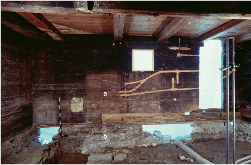
Abb.97: Bauzeitlicher Herdstellenbereich im Haus Unterblacki in Unterägeri (Kat. 18), 1510d oder kurz danach: a) Negativ der Vormauerung vor der rückwärtigen Giebelfassadenwand; b) Vormauerungen im Bereich des Herdsockels (Aufnahme nach Abtrag des Fussbodens in der Küche).
