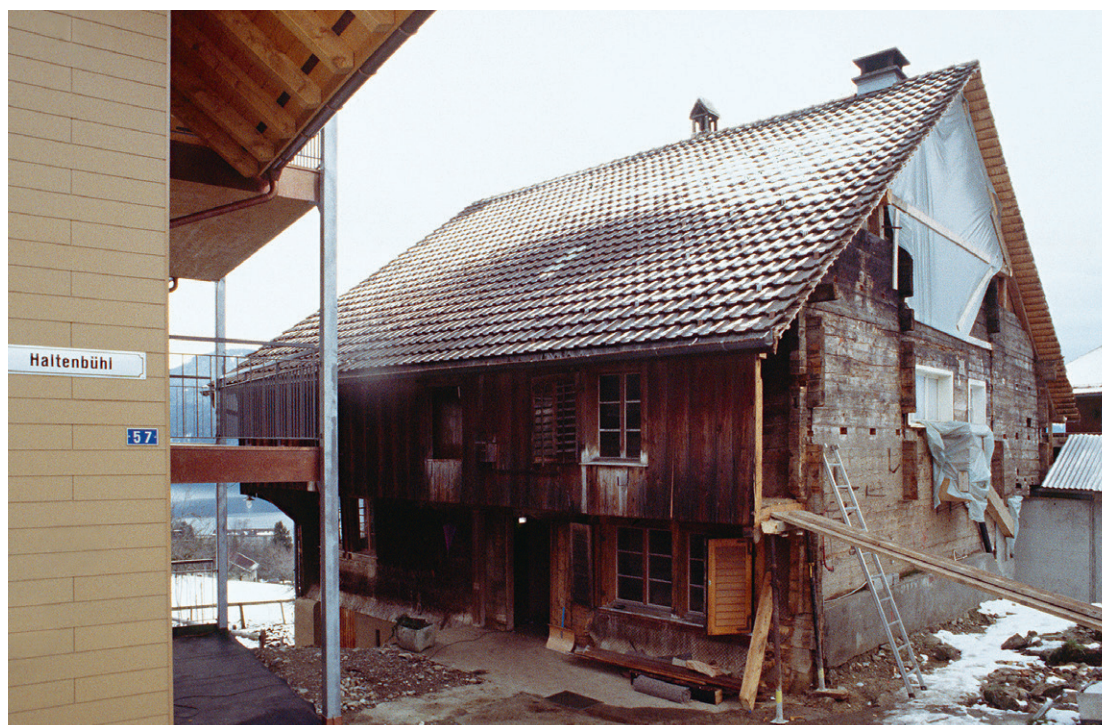
Abb. 212: Ansicht an die östliche Trauf- und die nördliche Giebelfassade (nach Abbruch des Schopfbaus) von Haus Eggstrasse 57 in Oberägeri.
