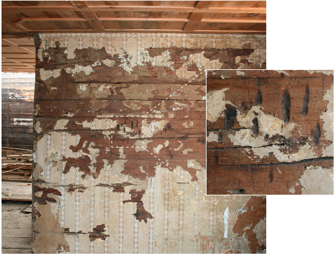
Abb. 144: In der Nebenstube von Haus Grubenstrasse 37 in Oberägeri (Kat. 11), 1518d, fanden sich an der Trennwand zur Stube gehäuft flammenförmige Brandspuren. Übersicht und Detail.
