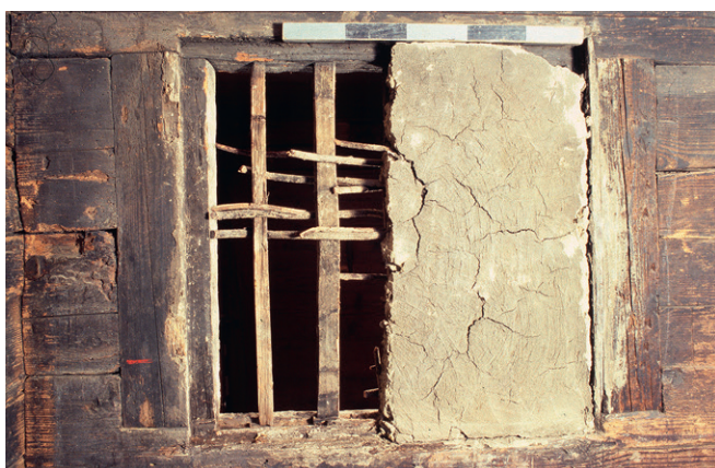
Abb. 38: Die fensterartige Binnenwandöffnung in der Querwand von Haus Chammersbüel in Unterägeri (Kat. 16), 1598d, wurde mit Rutengeflecht und Lehm verschlossen; Ansicht aus der Stube.
