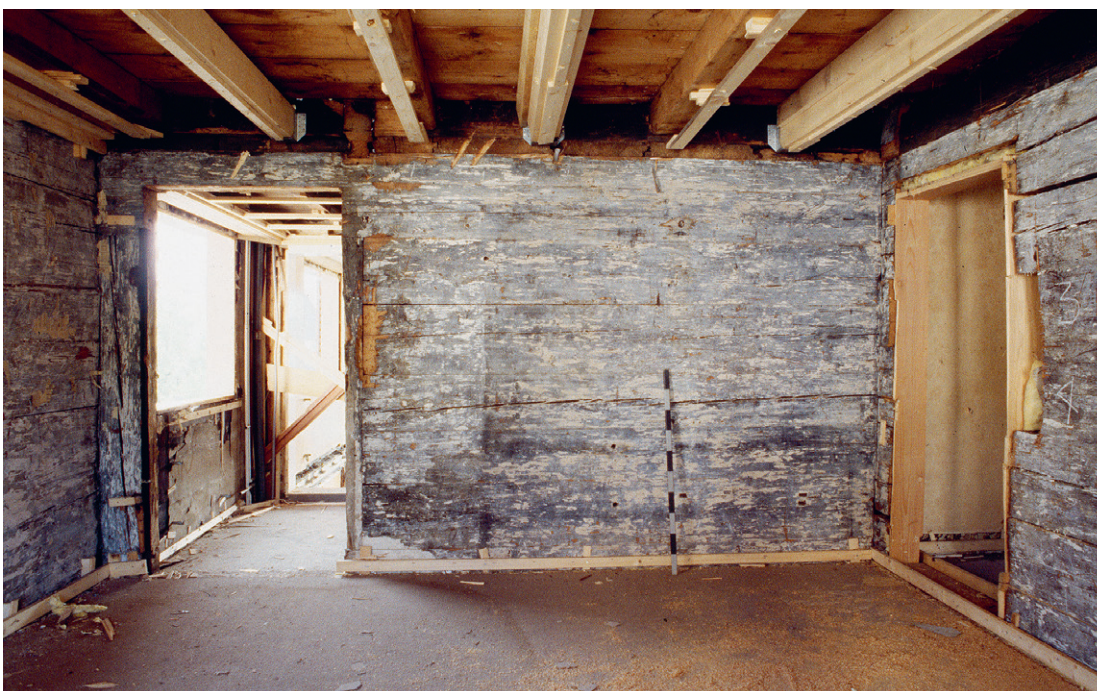
Abb. 239: Blick nach Süden in die östliche Kammer im Vorderhaus (2.1) des zweiten Vollgeschosses im Haus Hauptstrasse 1 in Oberägeri.
