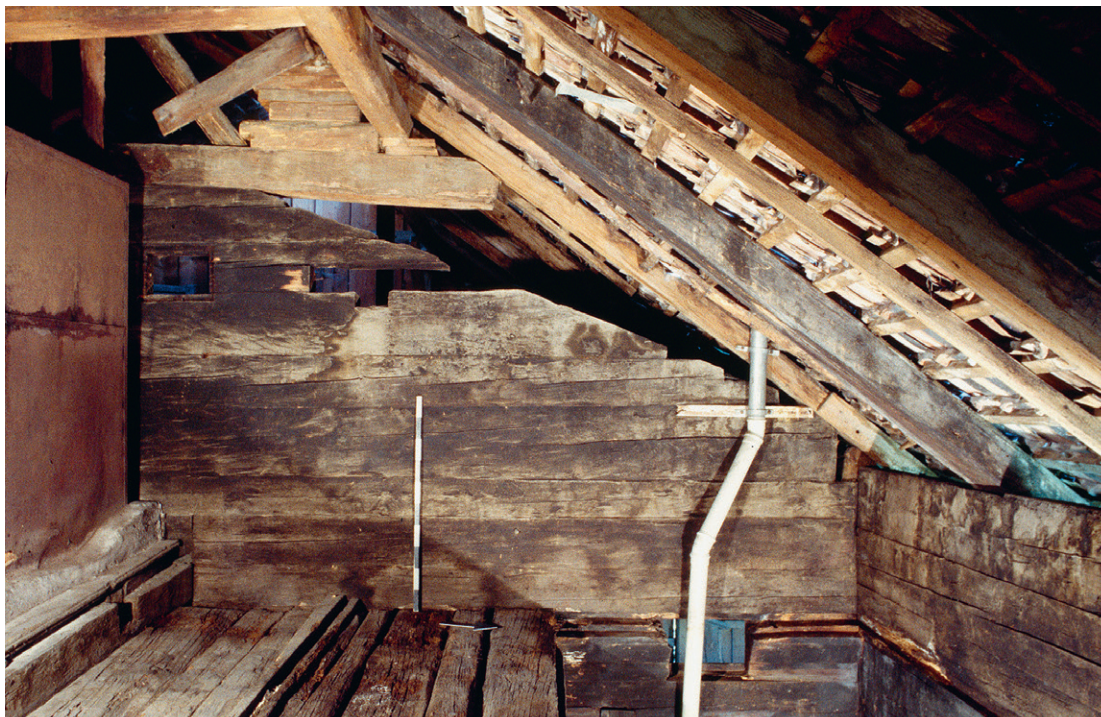
Abb. 168: Die ursprüngliche Dachneigung von Haus Halthof in Menzingen war an der Abschrägung der bauzeitlichen Balkenlagen abzulesen.
