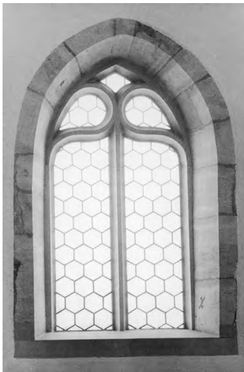
| Abb. 156 Schönbrunn, St. Bartholomäus. Kapelle des 15./16. Jahrhunderts. Nordöstliches Fenster des Altar- raums (Innenseite). Am rechten Gewände ist das Steinmetzzei- chen zu erkennen (Zustand vor der Restaurierung von 1972/73).
