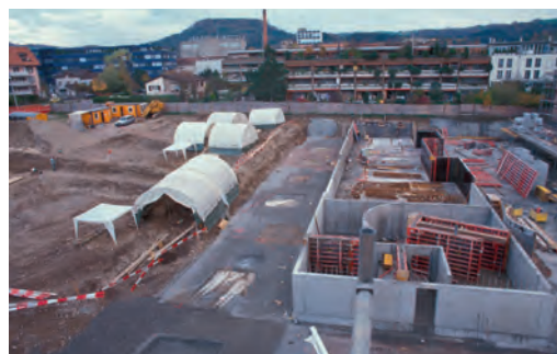
Abb. 5 Areal Früebergstrasse in Baar. Baubetrieb und archäologische Rettungsgrabung laufen parallel. Blick gegen Nordosten. Im Hintergrund ist die Baarburg gut erkennbar.
