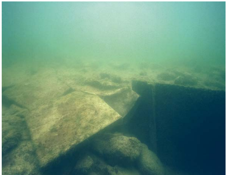
Abb. 42 Cham-Eslen. Schadensbild 2007: Die Gartenbetonplatten sind teilweise verkippt und fixieren das Geotextil (Bildmitte) nicht mehr.
