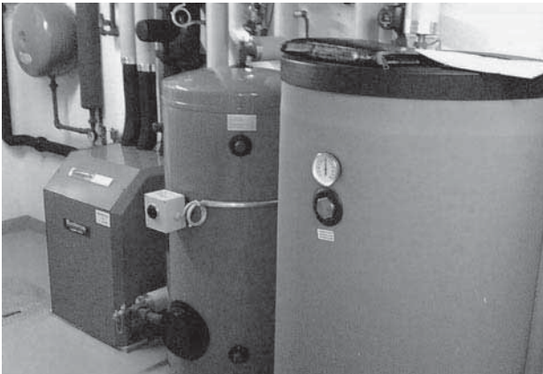
Erdsondenwärmepumpe bei Einfamilienhaus
