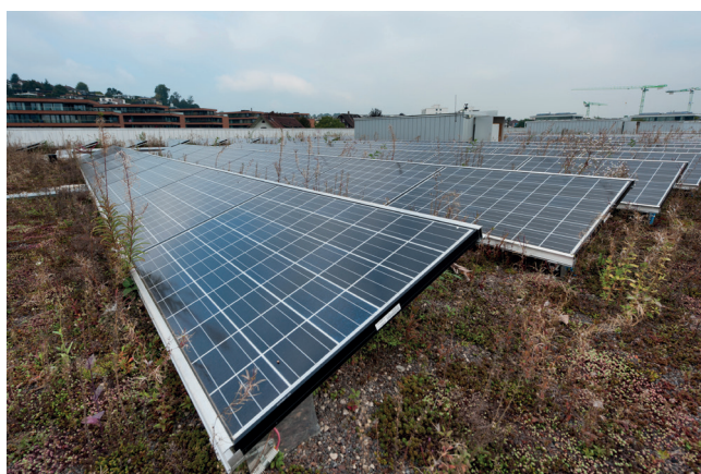
Photovoltaikanlagen Schulhaus Eichmatt
