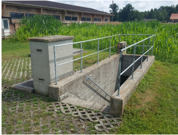
Saug- und Druckanlage Matten | Matten | Hünenberg
