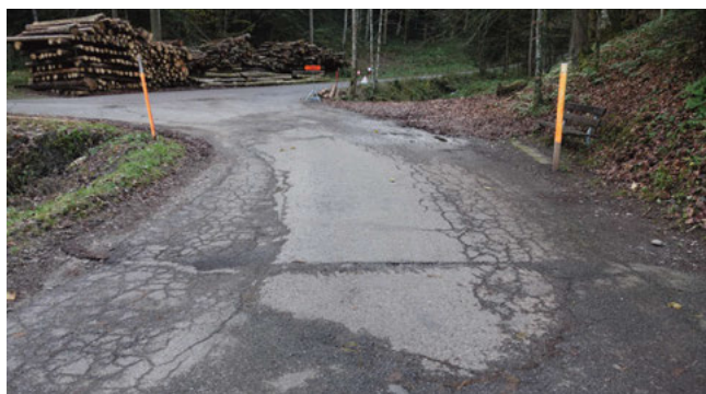
Abbildung 1: Risse im Bereich Kreuzung Mülibach
