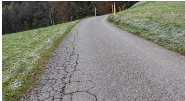
Abbildung 3: Belagsschäden Ausgang Finstersee
