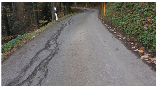
Abbildung 2: Längsrisse im Waldbereich
