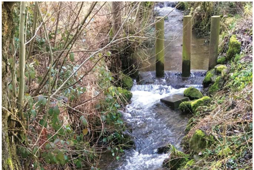
Abbildung 2: Chüntwilerbach mit Grobrechen
