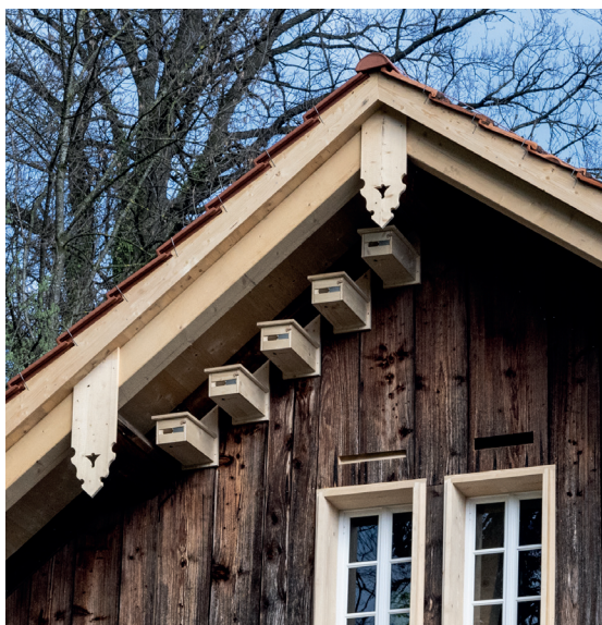
In der hölzernen Remise sind Nistplätze für Fledermäuse eingebaut.
