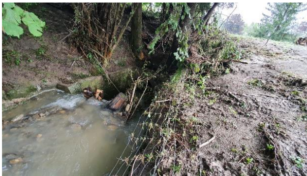
Abbildung 4: Geschiebeablagerung und Verringerung des Gerinnequerschnitts vor dem Durchlass Weidstrasse am Steintobelbach (SS_3010_5) (Quelle Foto: Kt. ZG)
