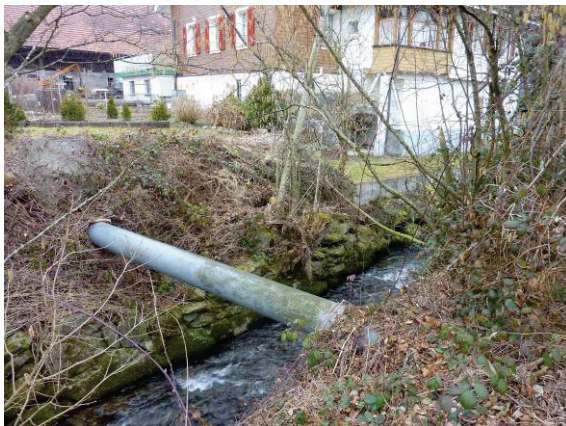
Abb. 3 Leitung bei Landhus (QP549).
