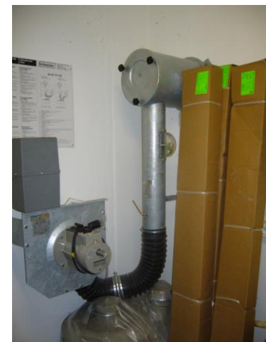
Schutzraumausrüstung beim Ventilationsaggregat
