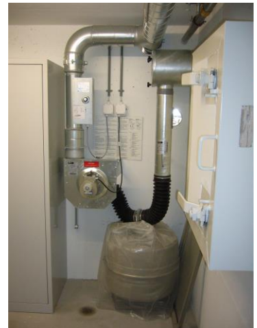
Ventilationsaggregat mit Direktverteilleitung
