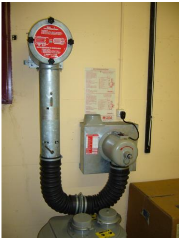
Ventilationsaggregat ohne Verteilleitung
