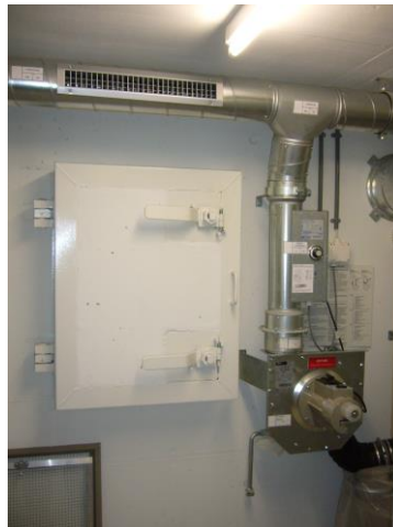
Ventilationsaggregat mit Querverteilleitung
